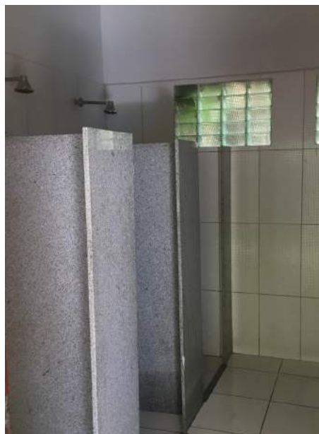
Figura 2.12 Banheiro sem portas internas, Residência 2133.
