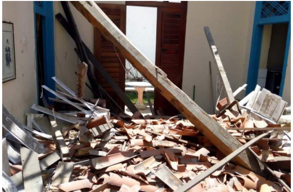
Figura 2.11 Desabamento da coberta em agos- to/2018. Fonte: mora- dores da residência 2133.
