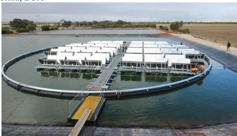
Figura 2.8 – Planta FV flutuante com rastreamento instalada em Holtville, Califórnia, EUA
