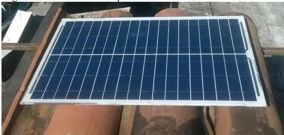
Figura 4.3 – Módulo de 20 Wp instalado no telhado do LEA/UFC
