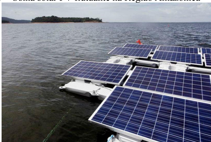
Figura 2.6 – Usina solar FV flutuante na Região Amazônica
