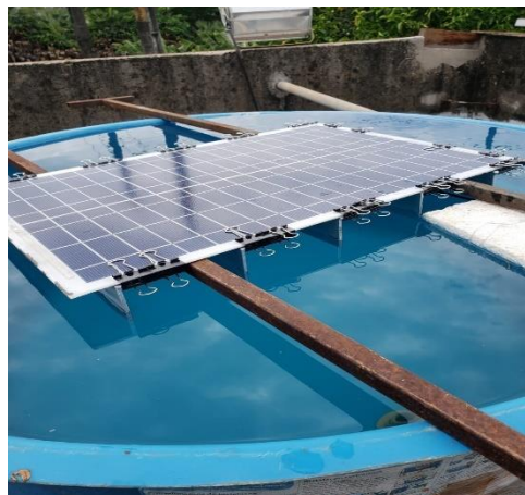
Figura 4.2 – Módulo de 20 Wp flutuante com pontes de calor apoiado em suporte no LEA/UFC
