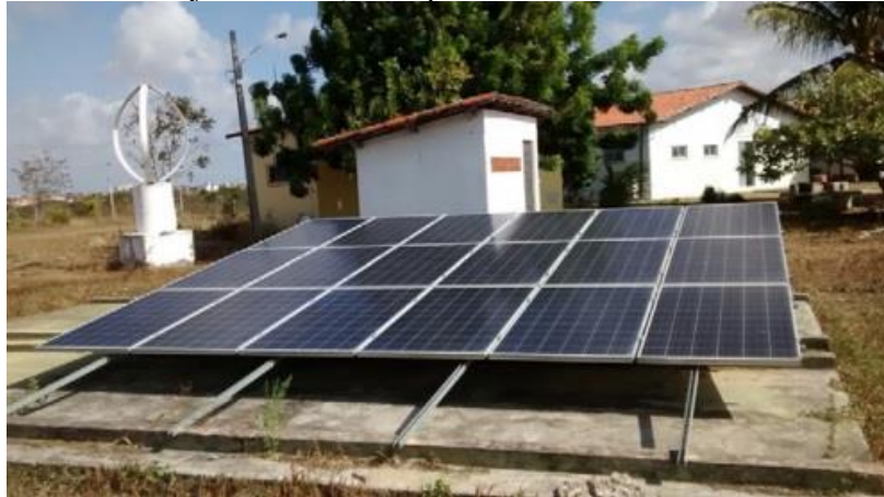
Figura 1.2 – Arranjo FV de 2,2 kWp instalado em Fortaleza
