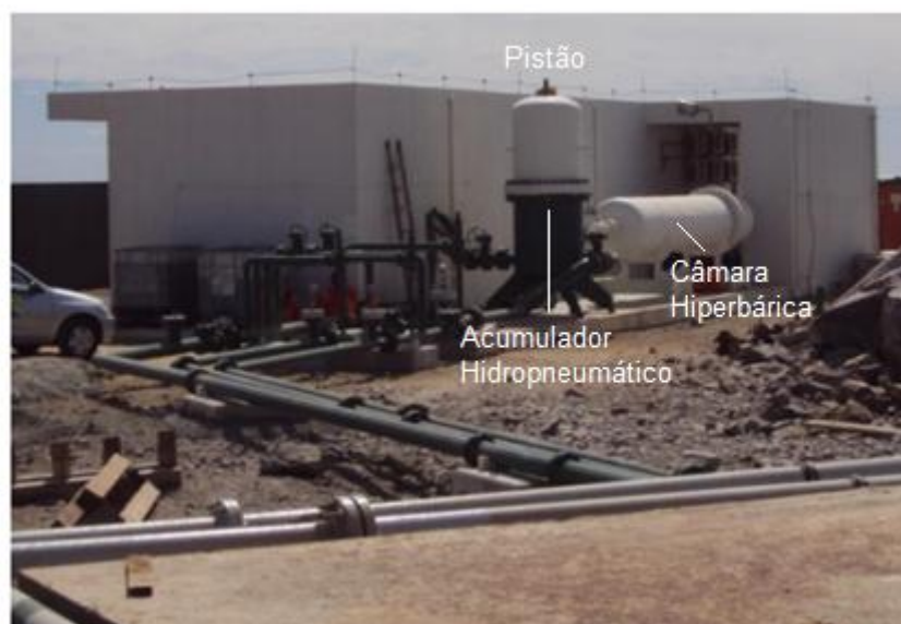
Figura 9: Sistema hidráulico do conversor de ondas marítimas desenvolvido pela COPPE/UFRJ.
