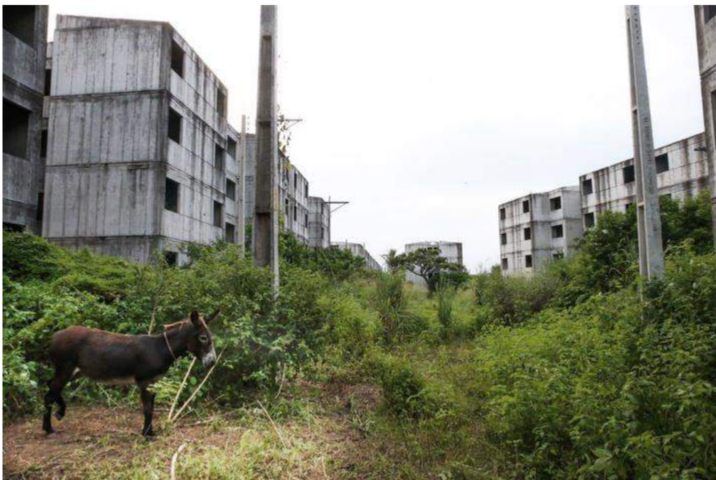
Figura 78 - Prédios abandonados no Conjunto Cidade Jardim Fonte: Portal G1 Ceará
