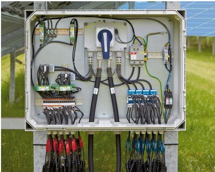
Figura 2.22 - Quadro de proteção dos arranjos FV ( combiner box ).
