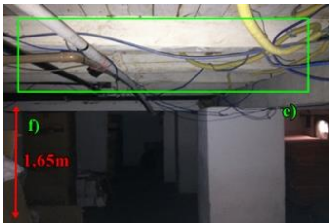
Figura 5 – Teto dos fundos do almoxarifado
