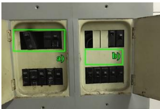
Figura 43 – Quadro de distribuição do raio x
