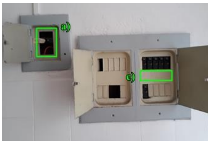
Figura 19 – Outros quadros de distribuição na enfermaria C
