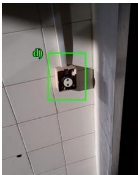
Figura 16 – Tomada sem tampa de proteção no corredor da enfermaria B
