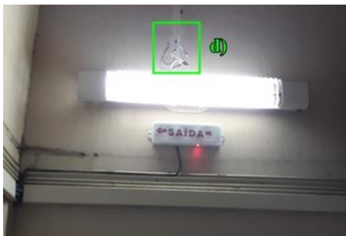
Figura 3 – Lâmpada fluorescente do corredor da administração
