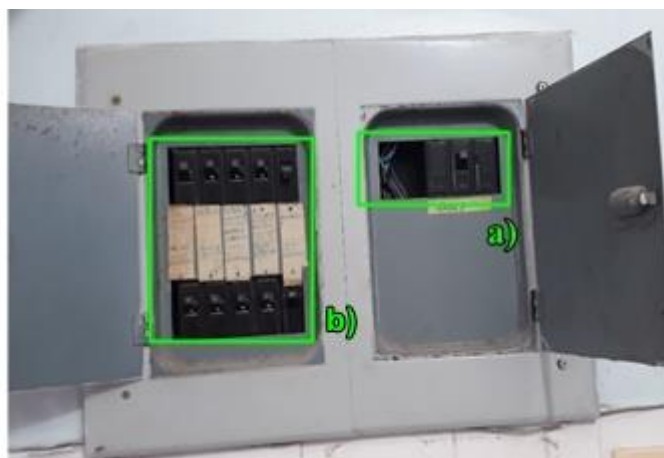
Figura 30 – Quadro de distribuição da neurologia
