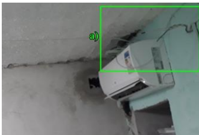
Figura 14 – Fiação exposta de ar condicionado no SESMT
