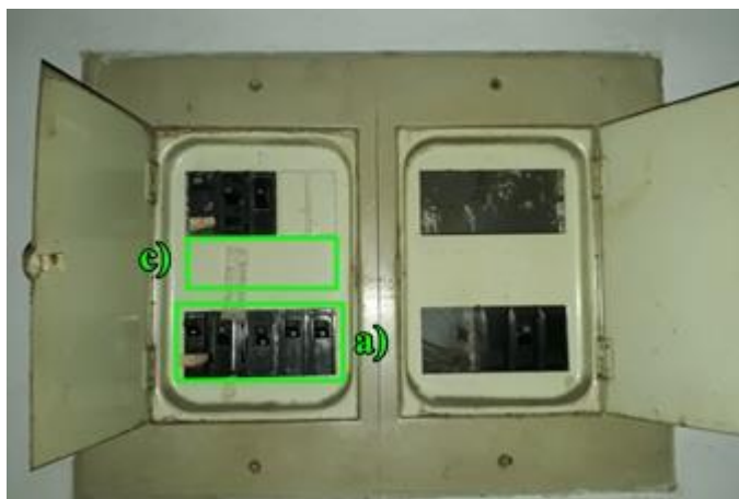
Figura 18 – Quadro de distribuição na enfermaria C
