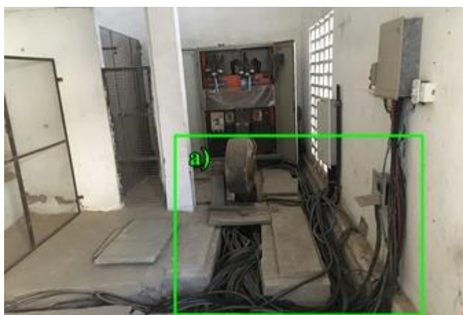
Figura 47 – Fiação da subestação
