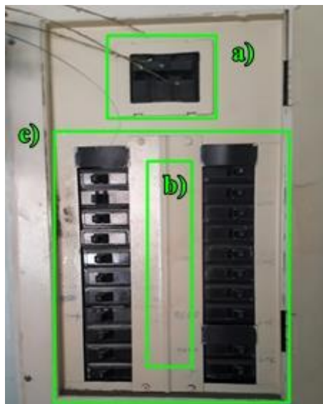
Figura 40 – Quadro de distribuição da tomografia
