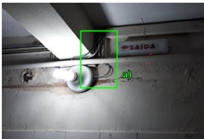
Figura 13 – Fiação exposta de lâmpada no RH
