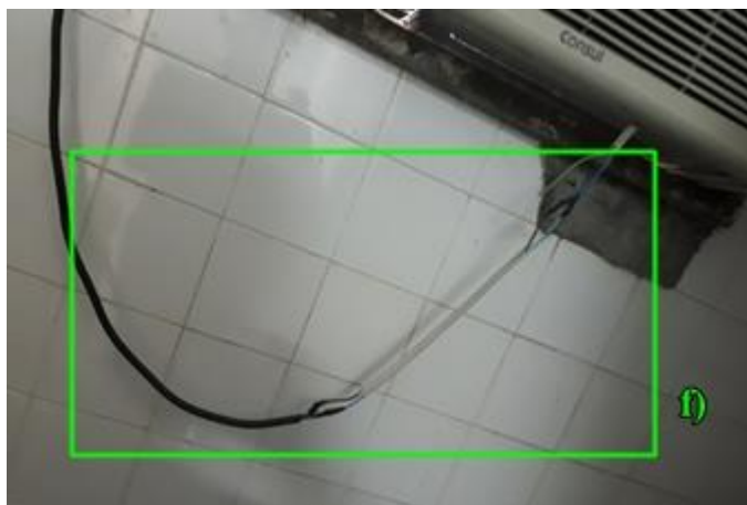
Figura 22 – Fiação exposta de ar condicionado na parede da TI
