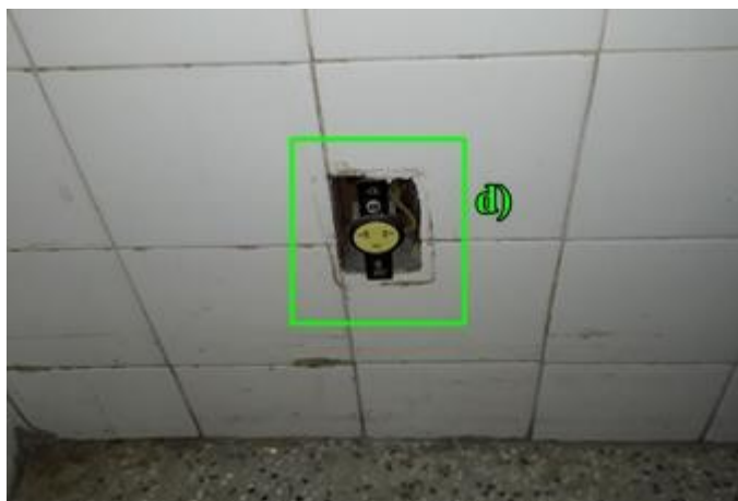
Figura 10 – Tomada baixa sem tampa de proteção no corredor da maternidade
