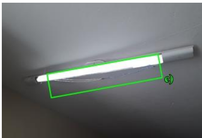
Figura 37 – Fiação exposta de lâmpada na eletrônica
