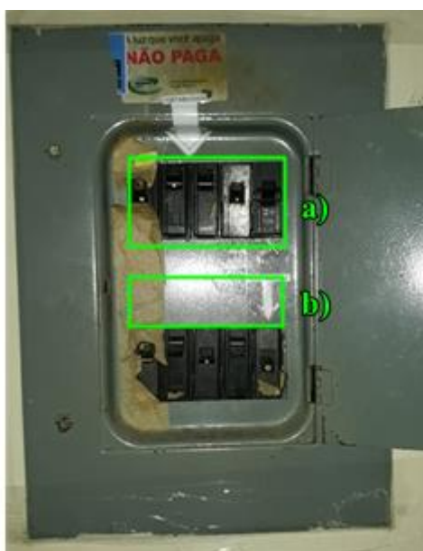
Figura 2 – Quadro de distribuição da administração
