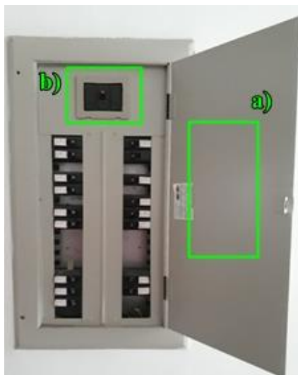
Figura 26 – Segundo quadro de distribuição da enfermaria D
