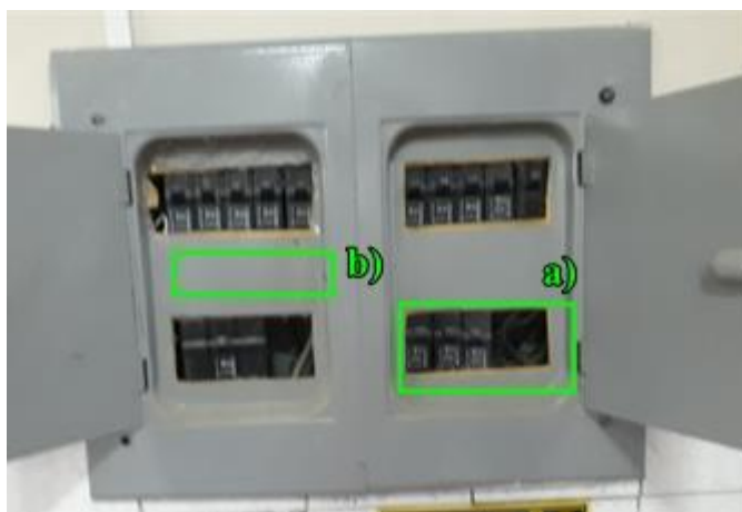
Figura 33 – Quadro de distribuição da oncologia
