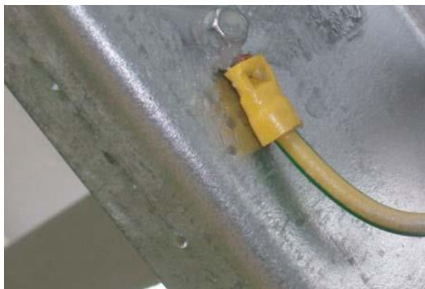
Figura 17 - Aterramento de estrutura
