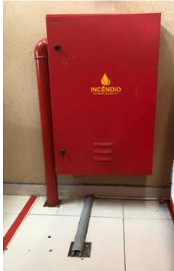
Figura 9: Material de combate à incêndios.
