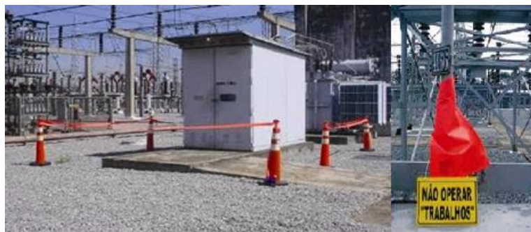
Figura 3 - Exemplo de delimitação de área e sinalização de energização.
