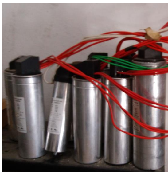
Figura 5.3 - Banco de capacitores analisado.
