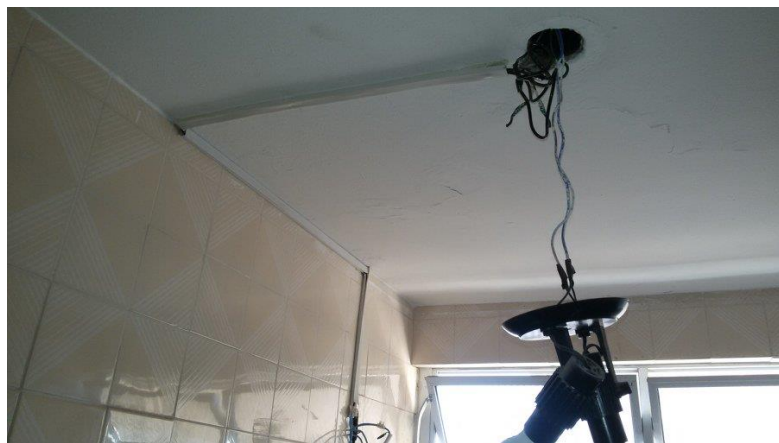
Figura 6 - Fios expostos oferecendo risco
