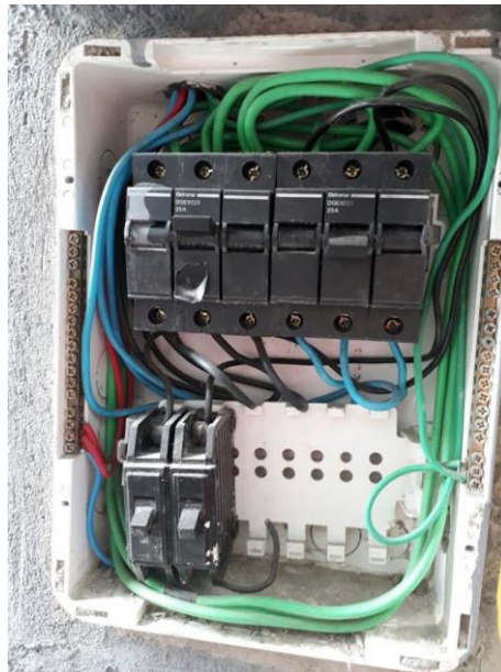
Figura 8 - Quadro de energia sem identificação, sinalização dos circuitos e sem tampa
