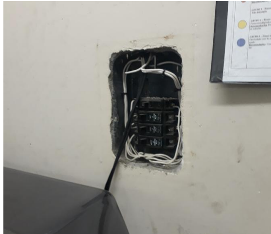
Figura 7 - Disjuntores sem caixa de proteção
