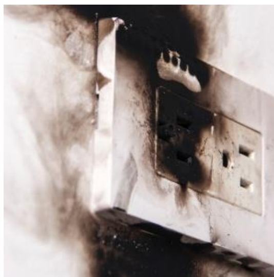
Figura 10 - Tomada após incêndio
