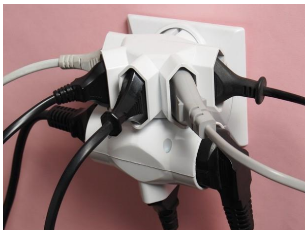
Figura 11 - Excesso de benjamins nas tomadas
