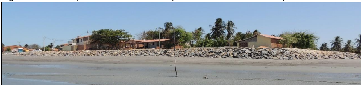
Figura 2 – Instalação de obra de contenção da erosão costeira na praia de Barrinha.
