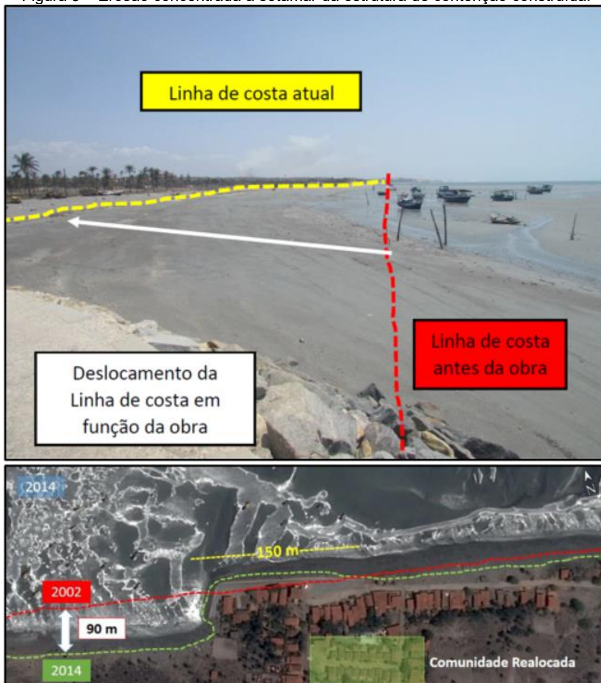
Figura 3 – Erosão concentrada a sotamar da estrutura de contenção construída.
