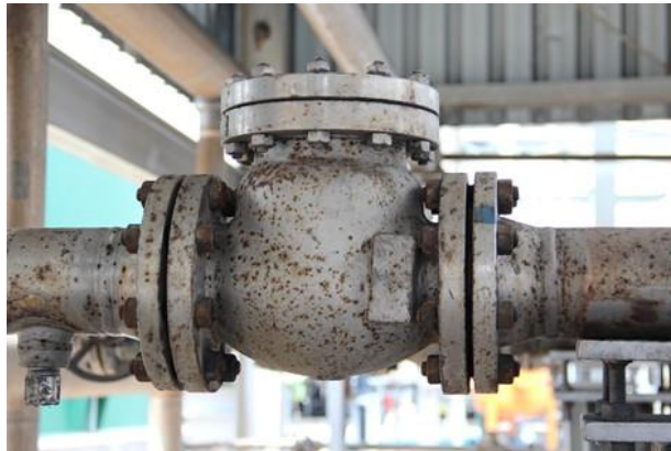
Figura 6 - Corrosão localizada em válvula de pressão em aço inoxidável AISI 316.
