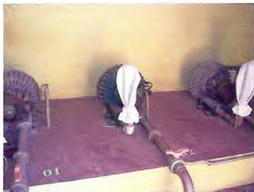
Figura 3 - Sopradores localizados na sala de aeração (7,5HP)
