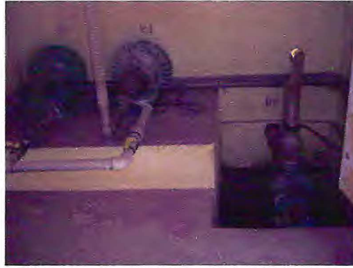
Figura 5 – Sopradores e Bomba de Captação
