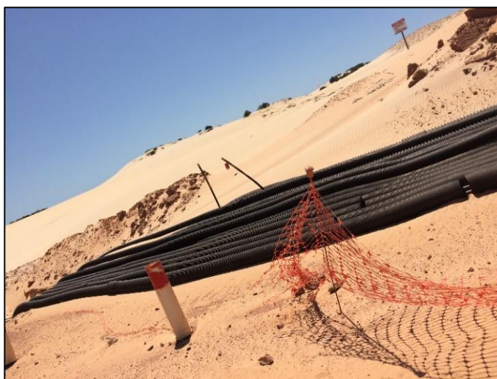
Figura 35 – Disposição dos cabos condutores de eletricidade no Cumbe.
