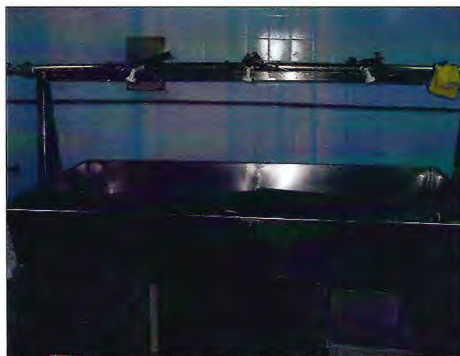
Figura 3- Mesa de aço inox com sistema de chuveiros acoplados, utilizados no recebimento das caudas de lagosta, na INTERFRIOS – Intercâmbio de Frios S/A, em Fortaleza, Ceará.
