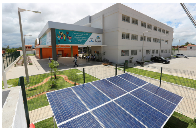
Figura 5. Painéis Solares na ETI Prof. Alexandre Rodrigues. (Fonte: Prefeitura de Fortaleza)
