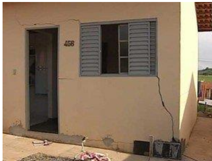
Figura 4 – Casa em construção pelo MCMV com falhas construtivas
