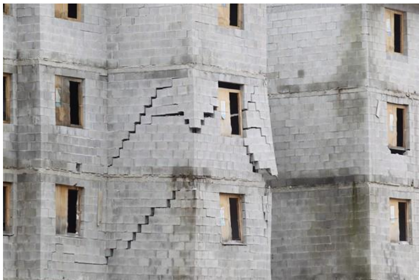
Figura 3 – Edifício em construção pelo MCMV com falhas construtivas
