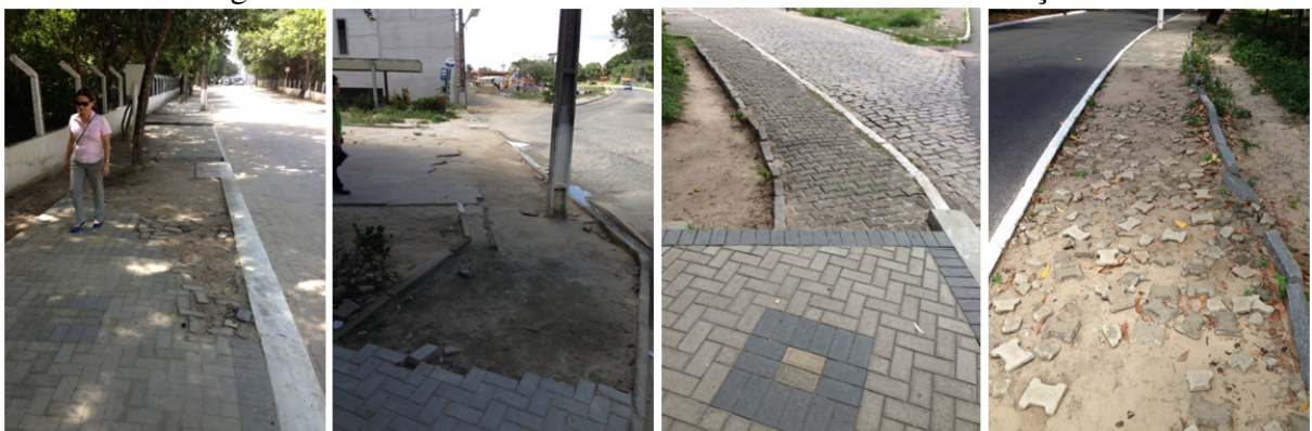
Figura 26 – Falhas nos revestimentos e continuidade das calçadas
