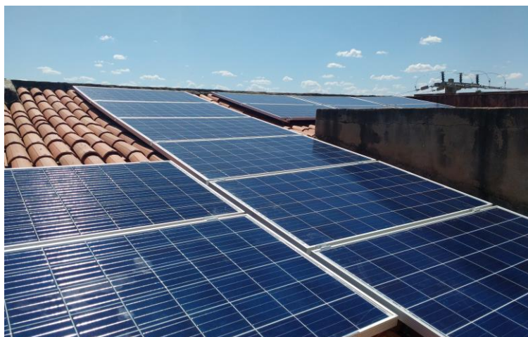
Figura 28: Sistema fotovoltaico 12,96kW em Acopiara, CE.
