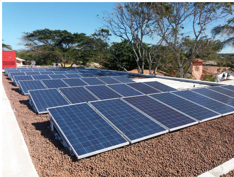
Figura 24: Sistema fotovoltaico 16,12kW.
