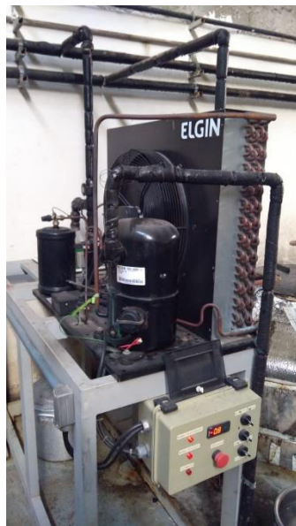
Figura 23 - Chiller para resfriamento de água.
