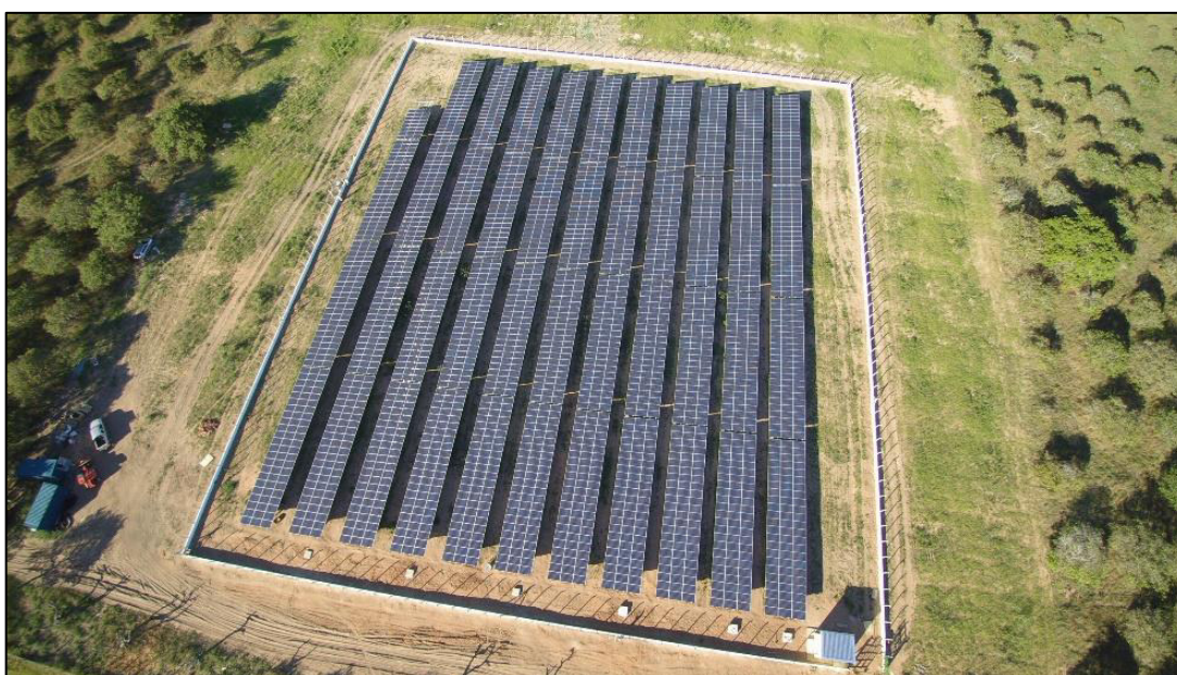
Figura 16 – Sistema Fotovoltaico Pacajus CE.
