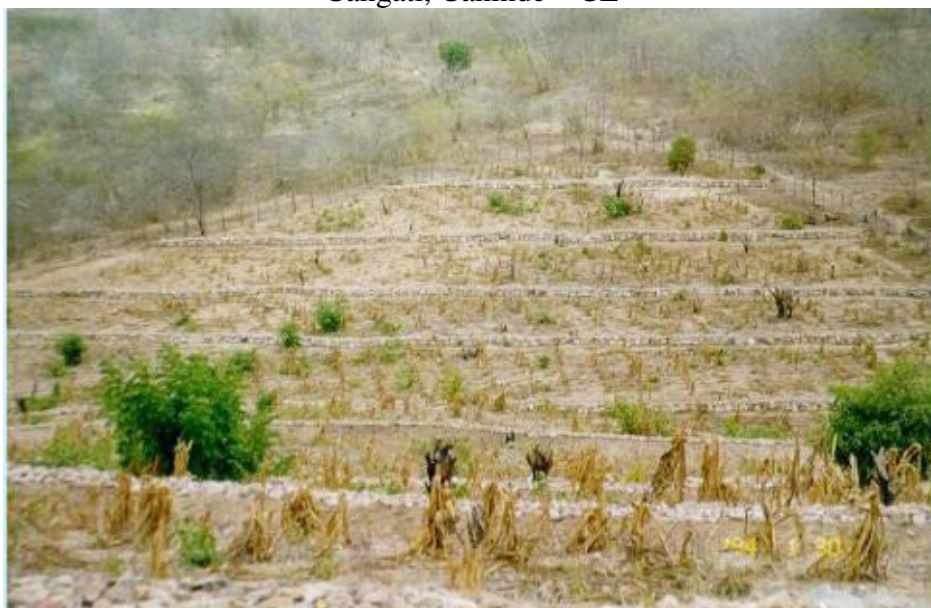
Figura 24 – Visão Geral dos Cordões de Pedra em Solos de Relevo Ondulado MBH do Rio Cangati, Canindé – CE
