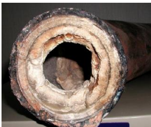
Figura 2 – Formação de incrustação no interior de uma linha não especificada.
