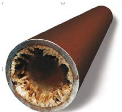
Figura 5 – Scale em tubulação.
