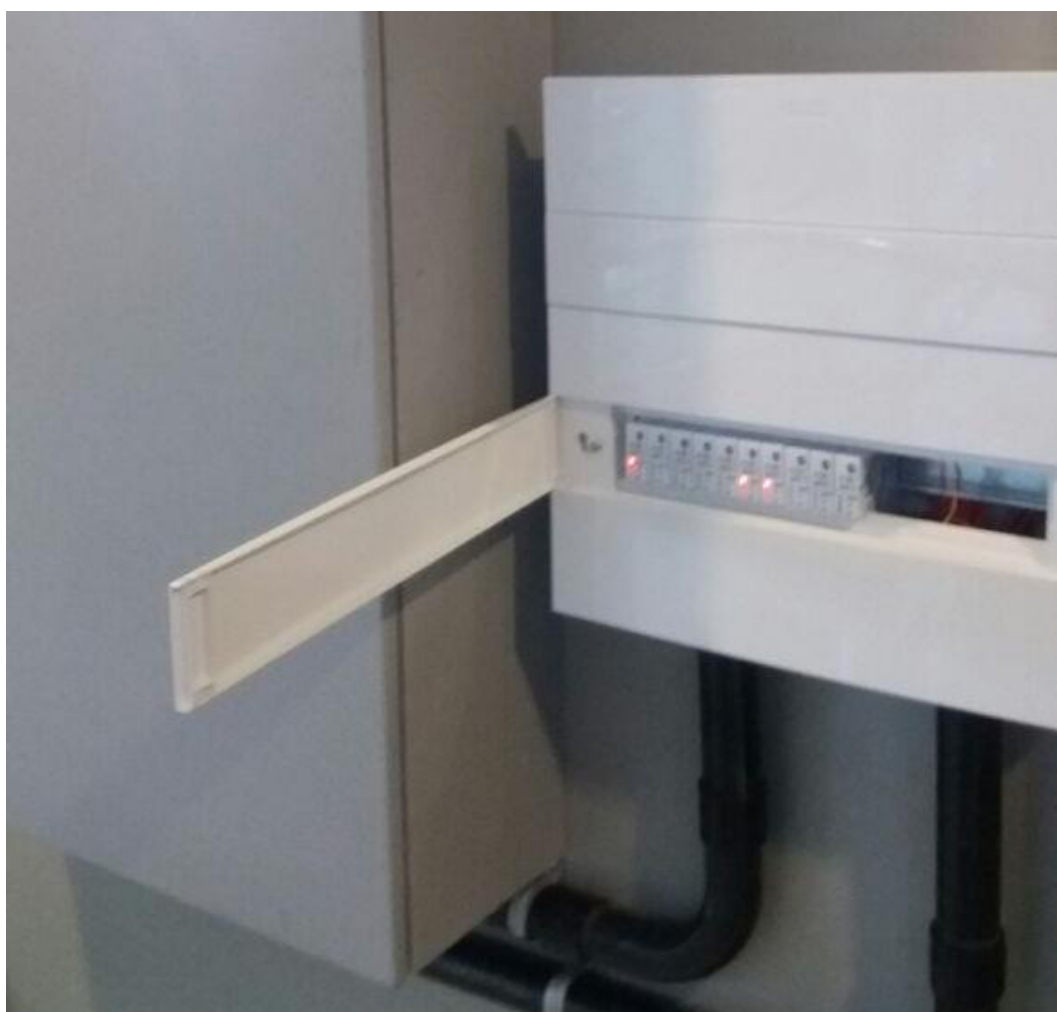
Figura 6 - Smart Quadro® em funcionamento
