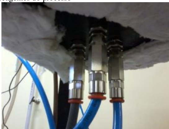
Figura 48 – foto do flange inferior do reator válvulas de retenção para fornecimento de reagentes do processo
