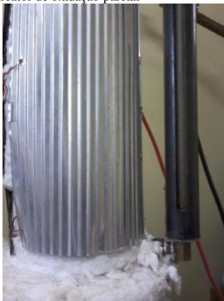
Figura 55 – Foto com detalhamento do indicador de nível instalado no corpo do reator de oxidação parcial
