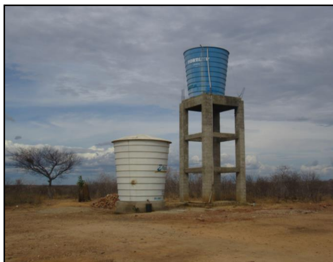
Figura 54 – Mini adutora da comunidade quilombola Jatobá, Patu (RN)
