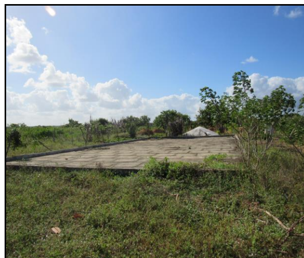
Figura 30 - Cisterna de enxurrada na comunidade quilombola Acauã, Poço Branco (RN)
