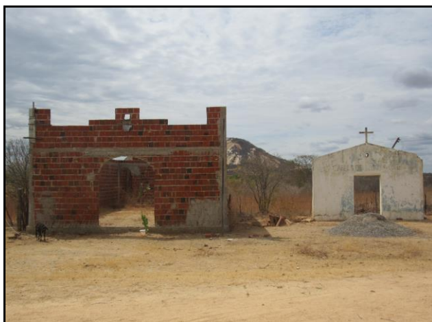
Figura 53 – Capela em construção e a antiga capela semidemolida da comunidade quilombola Jatobá, Patu (RN)
