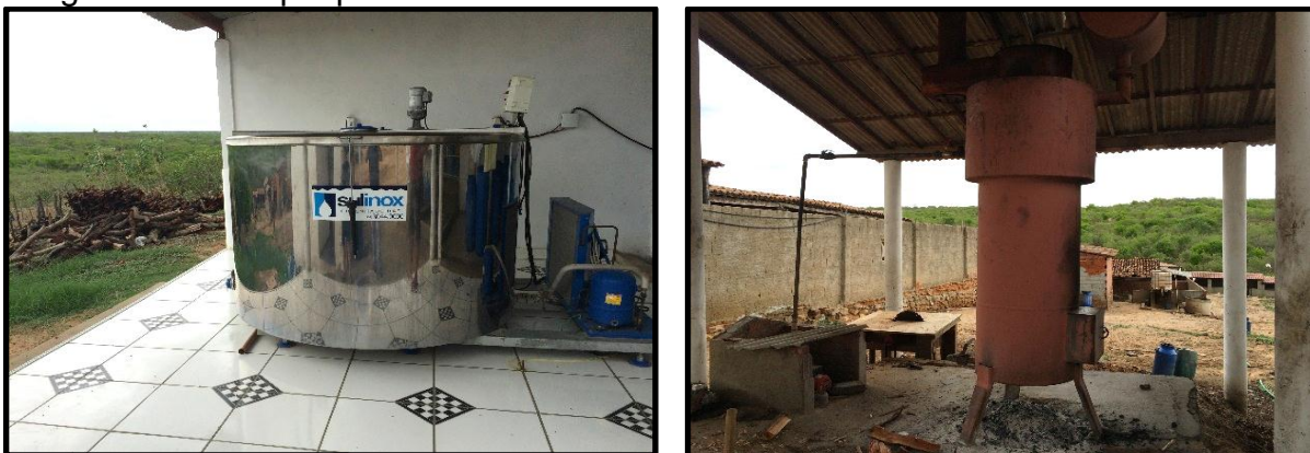
Imagem 21 - Tanque para conservar o leite e caldeira
