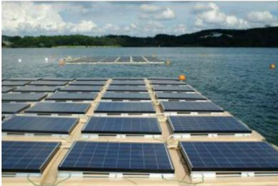
Figura 20 - Primeira planta FV flutuante foi instalado em Aichi, Japão em 2007.
