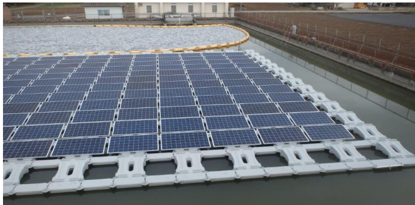
Figura 13 - Planta FV flutuante de 59 kWp instalado em Chiba, Japão utilizando módulos de silício cristalino.
