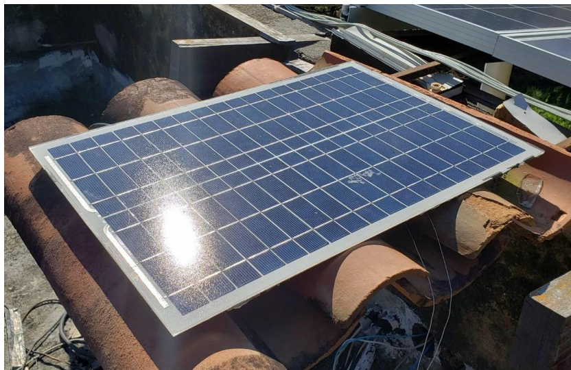
Figura 26 – Módulo Kyocera modelo KS20T instalado de forma convencional em telhado.
