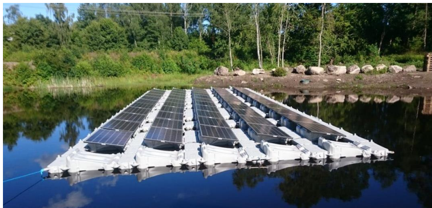
Figura 18 - Planta FV flutuante de 13 kWp instalado em um reservatório de irrigação na Suíça, utilizando a tecnologia Hydrelío.
