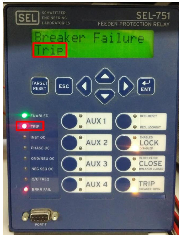
Figura 31 - Painel frontal do IED 1 (SEL 751) após emissão de comando de abertura de disjuntor (TRIP).
