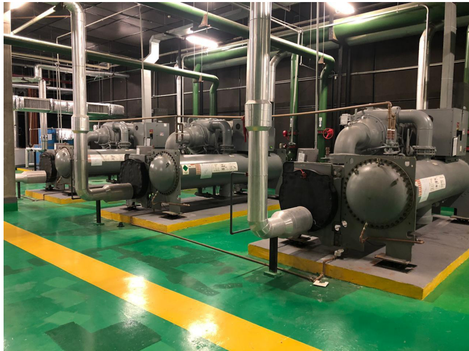
Figura 22: Conjunto de chillers.
