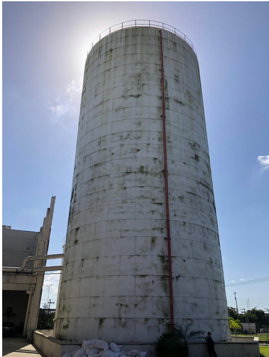
Figura 24: Tanque de termoacumulação.
