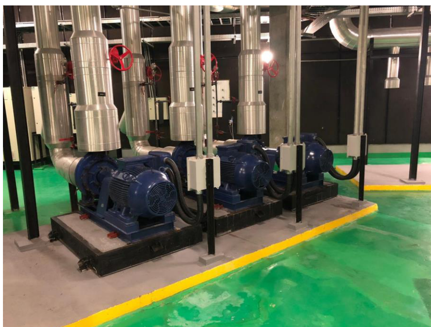
Figura 21: Bombas secundárias de 310 m 3 /h.
