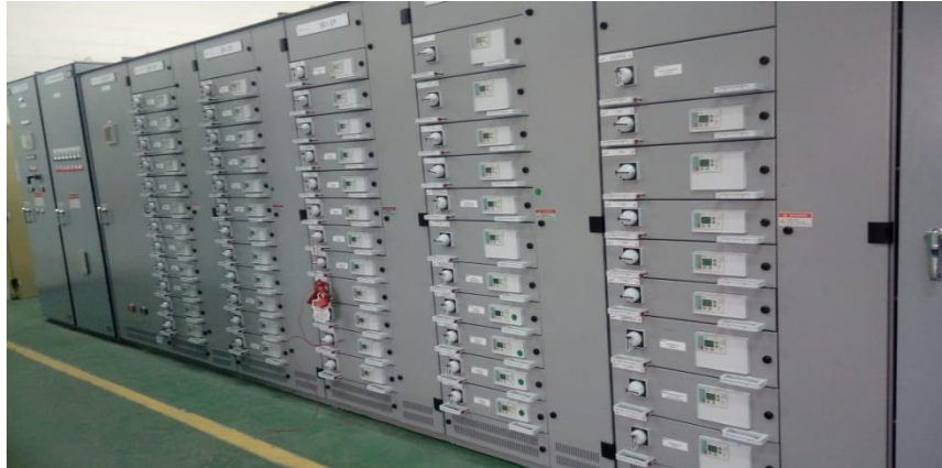
Figura 15 - CCM da Siemens
