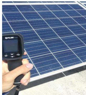
Figura 48 – Utilização da Câmera infravermelho para detecção de pontos quentes nos painéis
