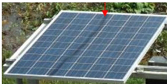
Figura 15 – Projeção da sombra do cabo elétrico
