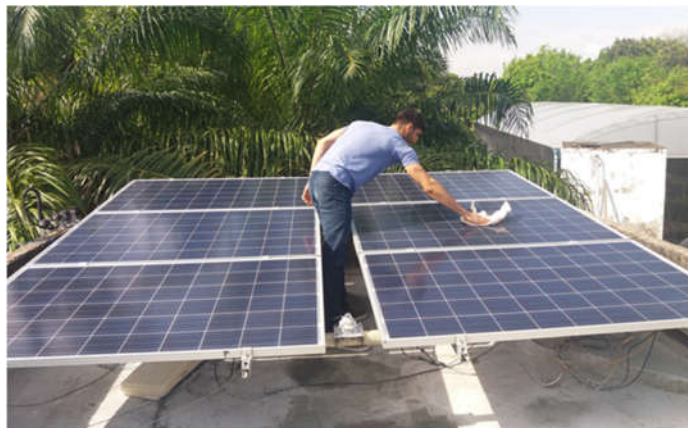
Figura 47 – Limpeza dos módulos FV para evitar não-idealidades
