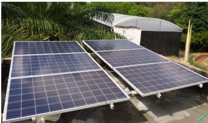
Figura 33 – Planta da microgeração FV instalada no LEA-UFC conectada à rede do campus
