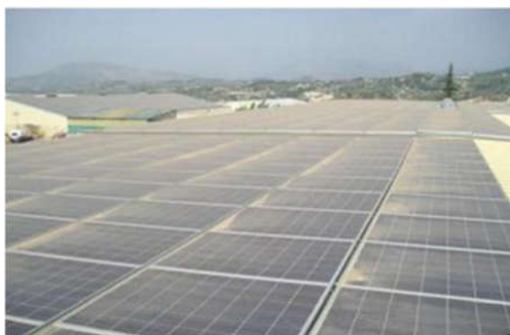
Figura 28 – Caso de sujidade não-uniforme em planta FV
