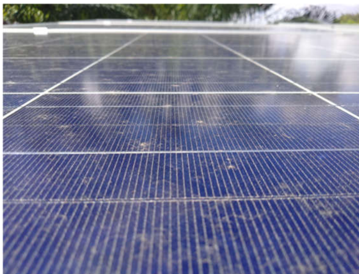
Figura 46 – Sujidade encontrada nos painéis FV
