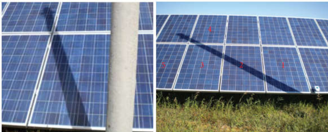
Figura 4 – Sombreamento do poste de distribuição nos módulos FV
