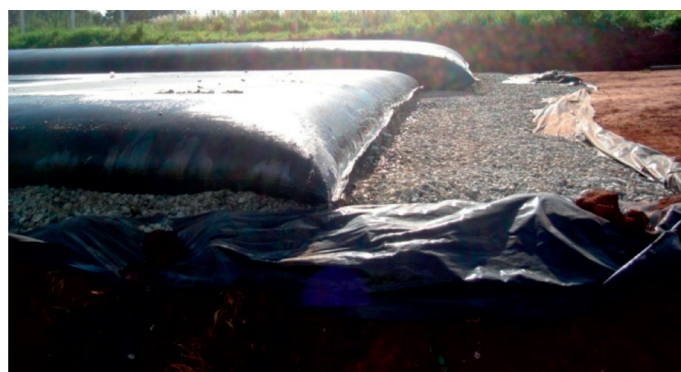
Figura 07 – Vista lateral do BAG em enchimento e desaguamento na ETE Coronel Macedo
