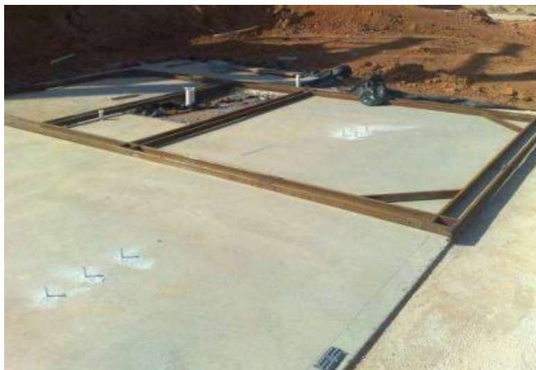
Figura 98 – Gabarito metálico para a demarcação do posicionamento das paredes do sistema DHARMA sobre a fundação
