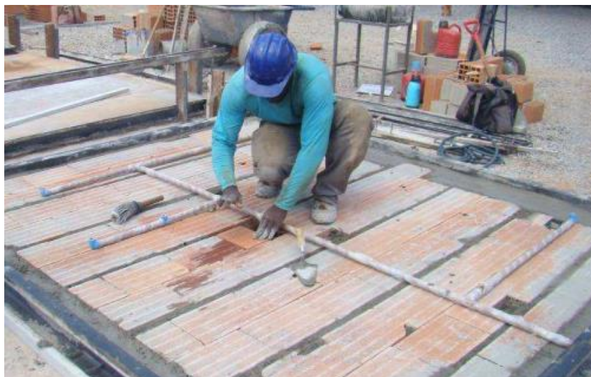
Figura 90 – Detalhe das tubulações hidráulicas no painel do sistema DHARMA
