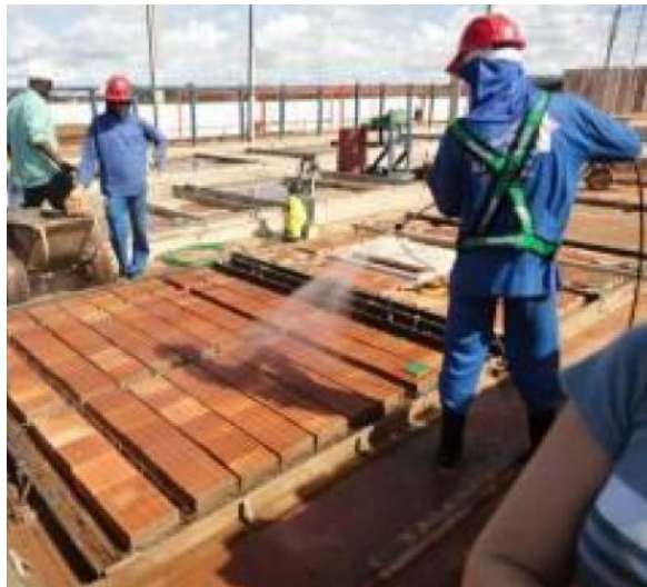
Figura 32 – Aspersão de água para umedecimento dos blocos antes da concretagem no sistema JET CASA
