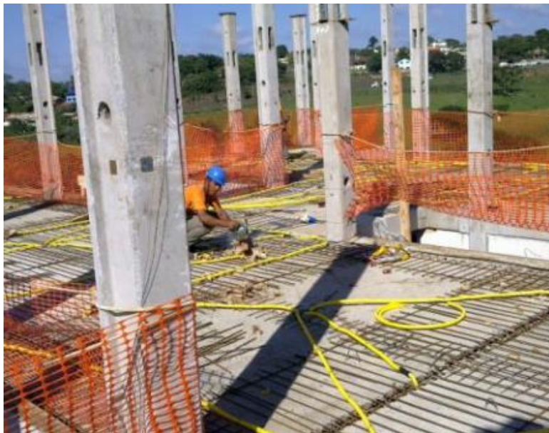
Figura 5 – Distribuição de armadura negativa e eletrodutos sobre pré-laje no sistema construtivo PRECON
