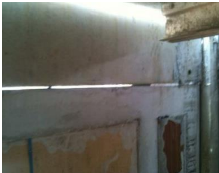
Figura 125 – Vão existente entre o painel e a viga no sistema PRECON
