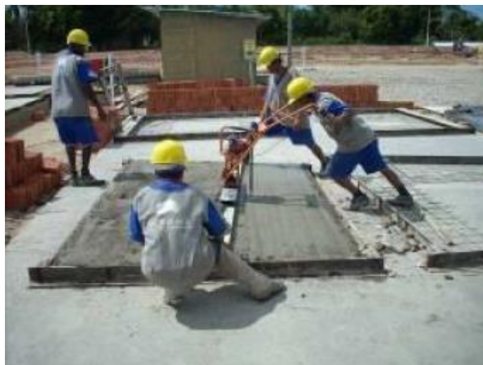
Figura 137 – Lançamento e adensamento de argamassa com régua vibratória da última camada do painel Olé
