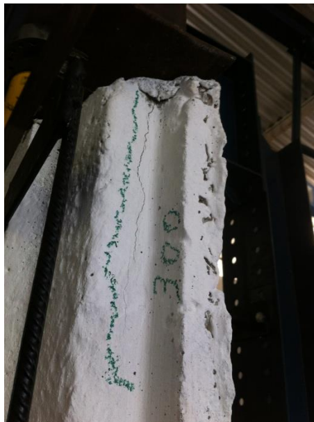
Figura 156 – Ocorrência de fissura na carga de primeiro dano do corpo de prova 03 na interface concreto-bloco cerâmico do painel (comprimento de fissura = 20 cm)
