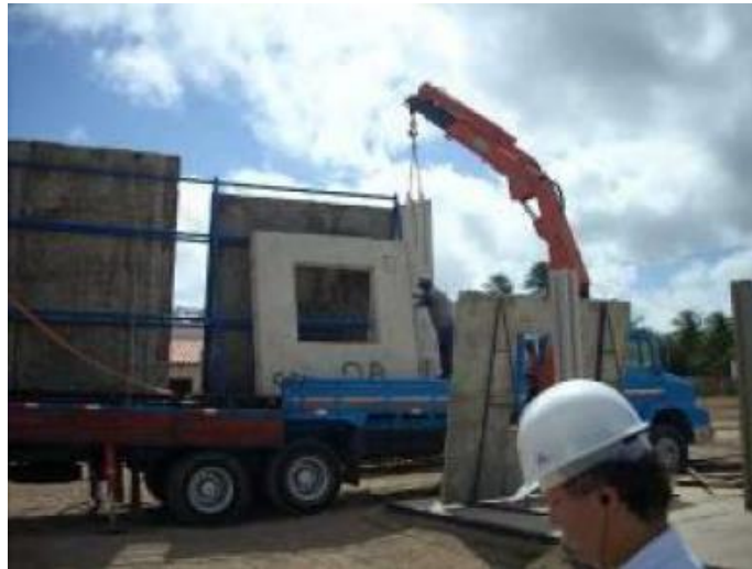
Figura 139 – Transporte do painel da pista de produção até local final de montagem no sistema Olé
