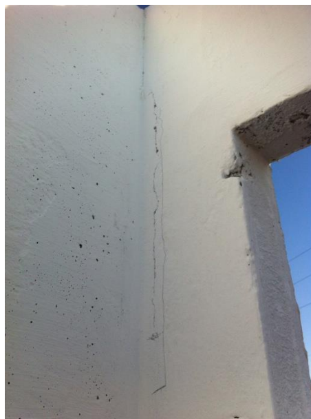
Figura 163 – Fissura ocorrida na ligação do painel com painel adjacente após a energia de 960 J com impacto pelo lado da argamassa
