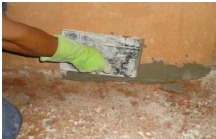
Figura 74 – Aplicação de argamassa com impermeabilizante na base dos painéis do sistema CASA EXPRESS
