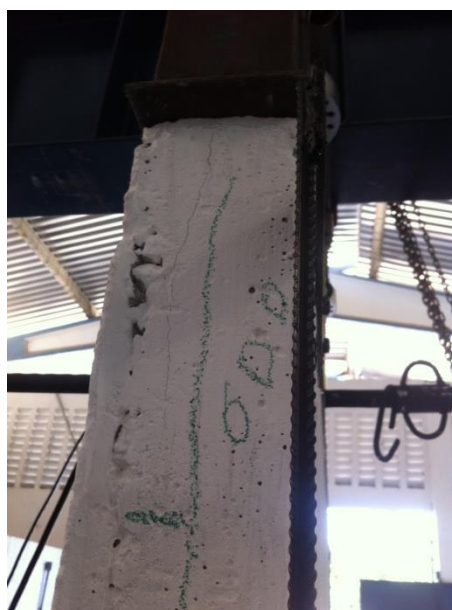
Figura 159 – Modo de ruptura do corpo de prova 03 durante o estado último de resistência (interface concreto-blocos cerâmicos)
