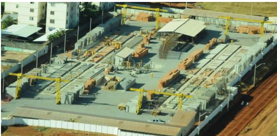
Figura 21 – Vista geral de uma unidade de produção de painéis em canteiro de obras do sistema JET CASA
