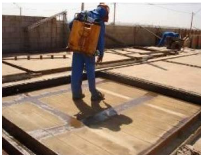
Figura 27 – Preparação de forma com aplicação mecanizada do desmoldante no sistema JET CASA
