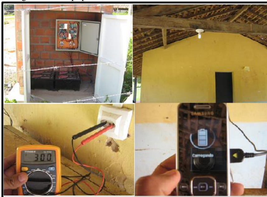
Figura 1.3 - Equipamentos sendo alimentados em 311 Vcc.
