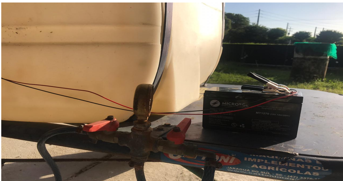
Figura 15 - Energização do sistema através de uma bateria de 12V
