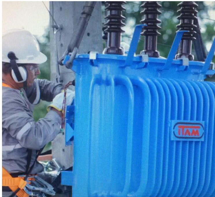
Figura 6 - Transformadores de distribuição revendidos pela empresa AWD Energia para uso na orla marítima.
