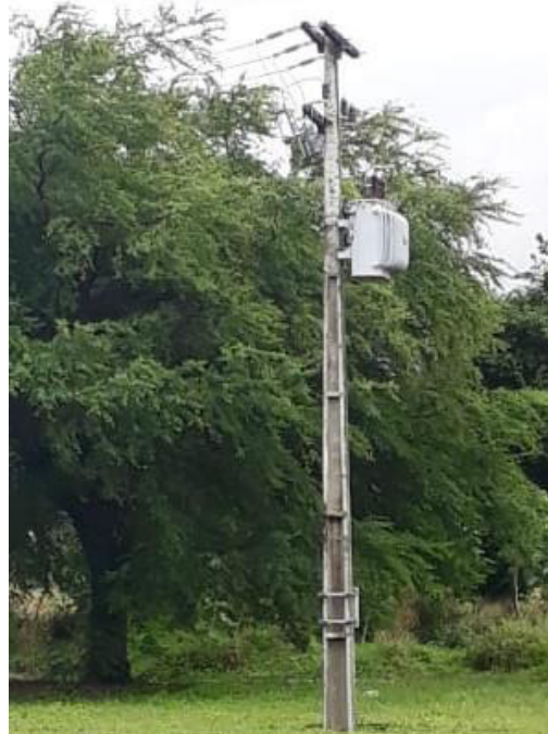
Figura 5 - Transformador de distribuição revendido pela empresa AWD Energia para uso padrão, na Universidade Federal do Ceará.
