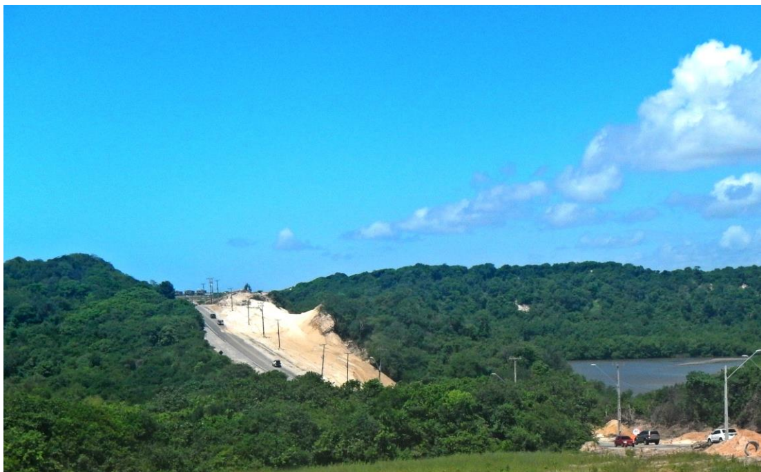
Figura 13: CE-025 meio a dunas fixas, Aquiraz-CE. Note o desmatamento para duplicar a CE-025, aumentando os impactos ambientais da via de acesso ao Porto das Dunas sobre a vegetação. Ceará, maio de 2019.
