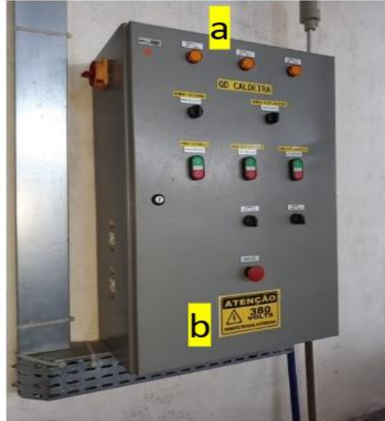
Figura 9 – Parte externa do quadro elétrico
