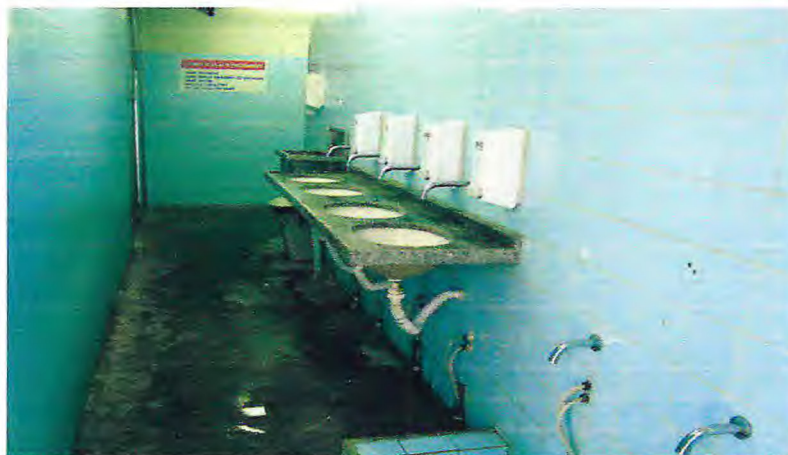
Figura 17 - Gabinete de higienização na indústria INTERFRIOS – Intercâmbio de Frios S/A, em Fortaleza, Ceará.
