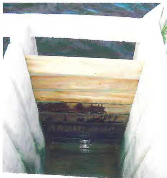
Figura 6 - Fechamento das comportas e colocação de esponjas entre as tábuas de nível para a vedação da comporta.
