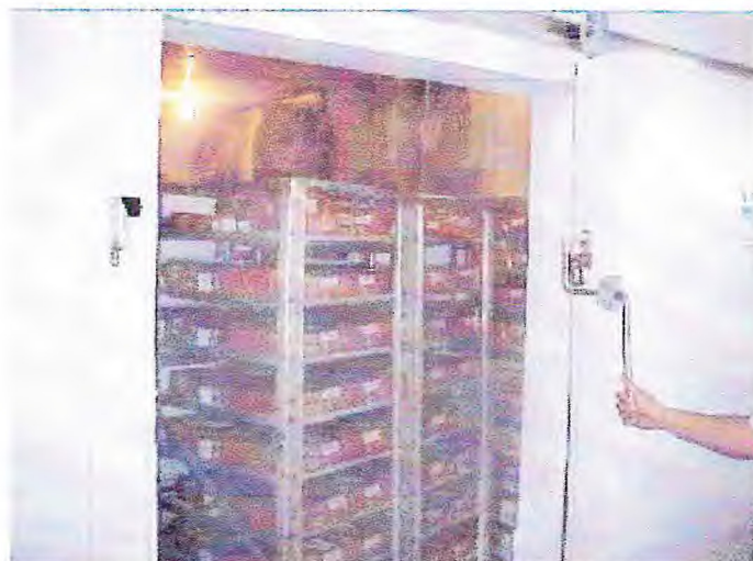
Figura 17 – Túnel de congelamento
