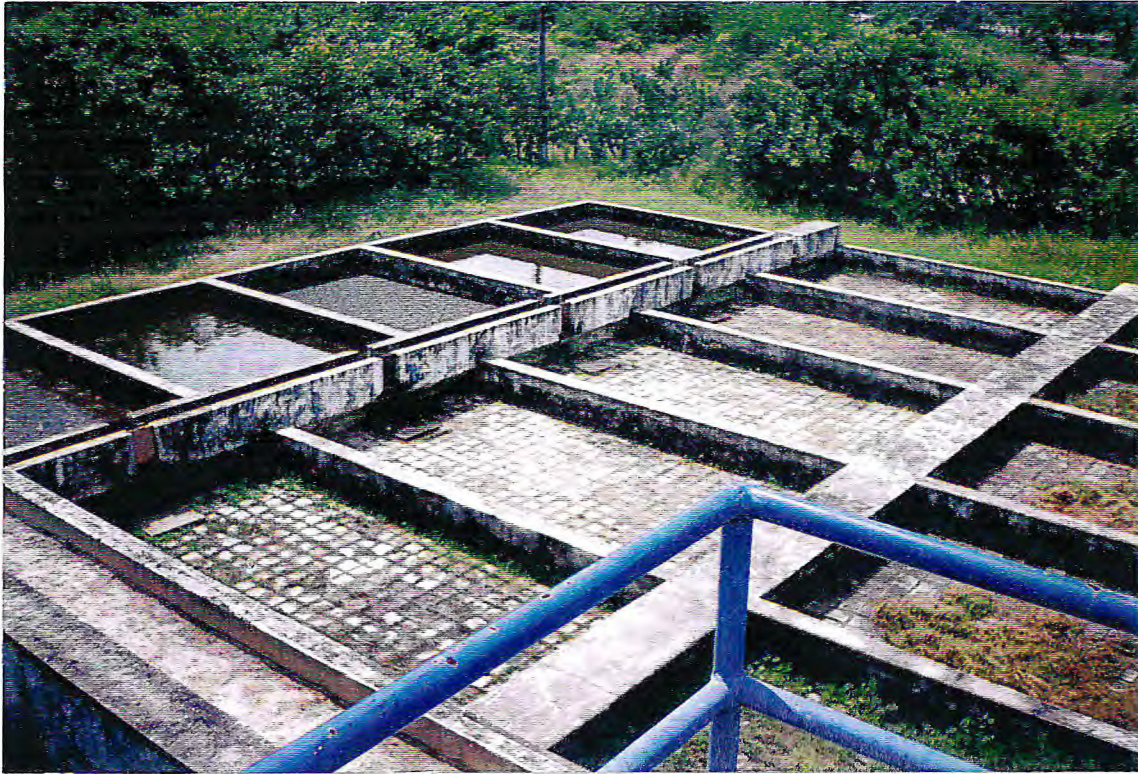
Fig. 6 - Leitos de Secagem do Lodo.
