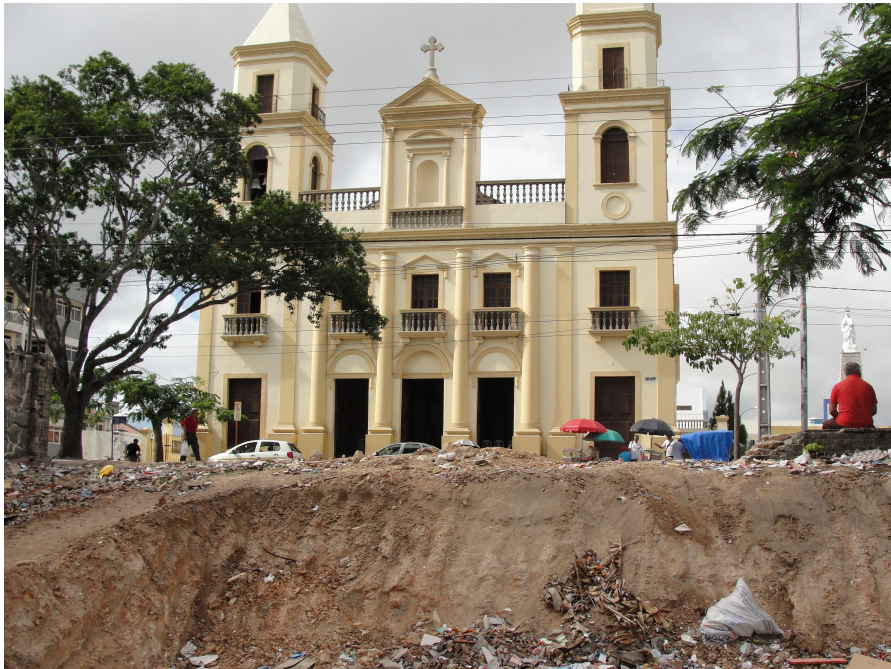
Figura 5 – Fotografia feita dentro do terreno na Av. Floriano Peixoto, evidenciando o barranco formado pela destruição, defronte a Catedral N.Sra. da Conceição.
