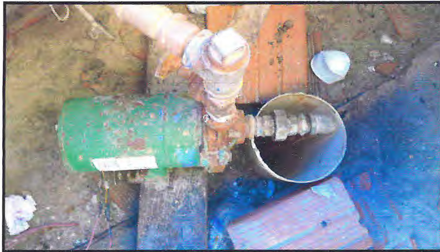
Foto 26. Bomba elétrica no poço P11 Coordenadas 596404 / 9539018 localizada na Escola Municipal do Sítio Lucas Beberirbe CE (junho 2012).
