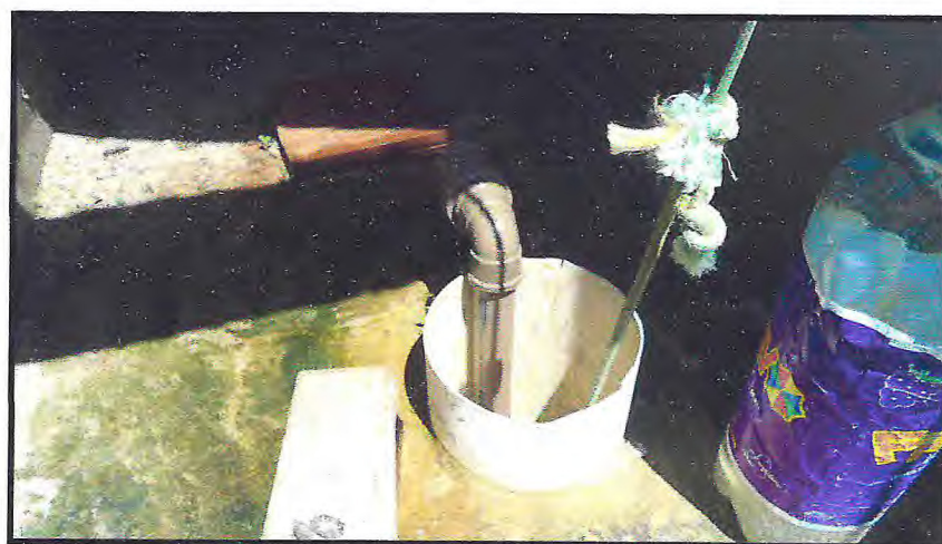
Foto 19. Tubo de PVC branco, de espessura fina e diâmetro de 6 cm no P4. (Fazenda N.V) Coordenadas 595205 / 9540808. Beberibe CE (junho 2012).
