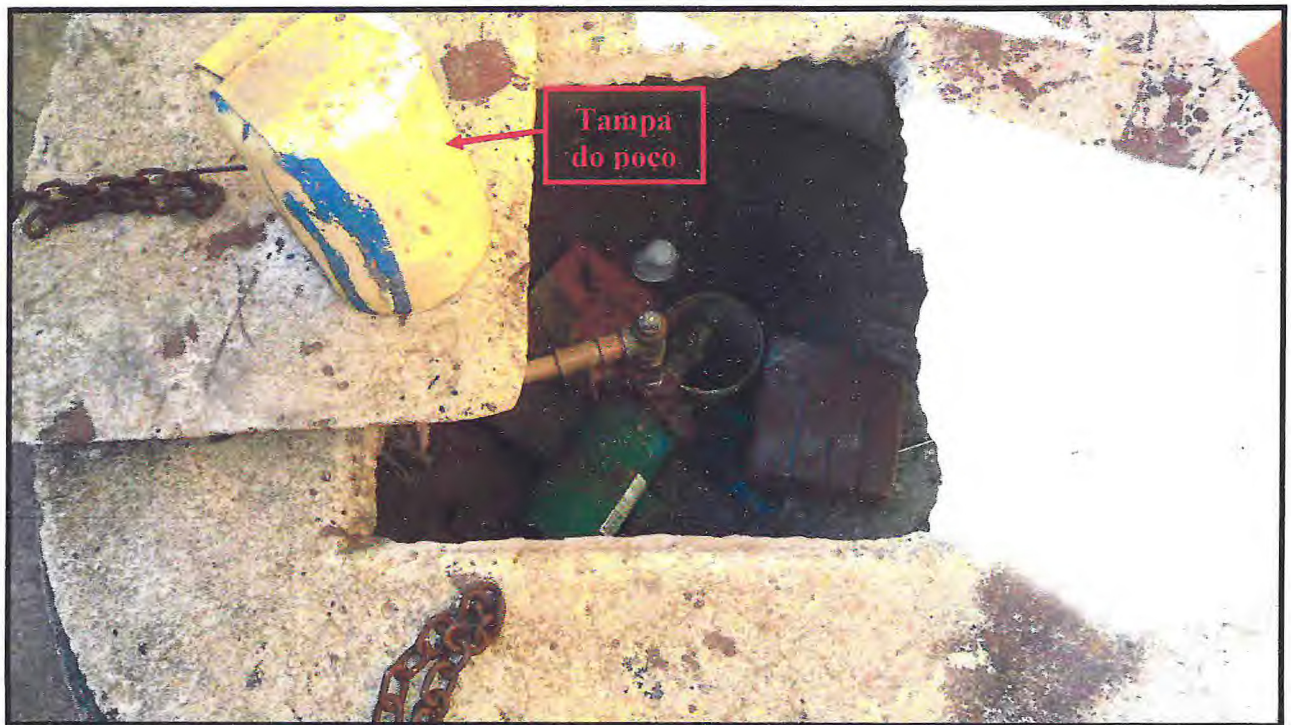
Foto 21. Foto de proteção para uma obra de captação, com tampa de PVC para o poço, um anel de concreto que isola o poço contra qualquer contaminação externa. P11 Coordenadas 596404/ 9539018 Escola Municipal na comunidade do Sítio Lucas Beberibe CE (junho 2012).
