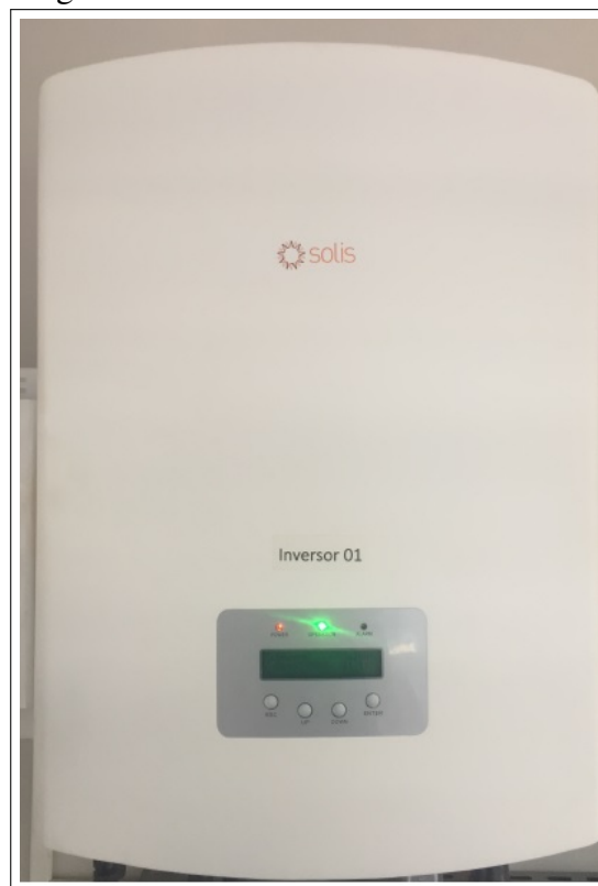
Figura 17 – Inversor Solis 15K
