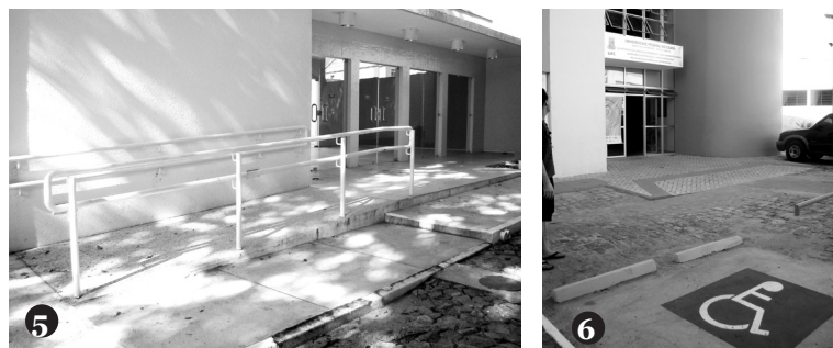
Foto 5 – Auditório Valnir Chagas – Faced/UFC. Rampa com inclinação adequada e corrimão próximo ao exigido pela NBR-9050
