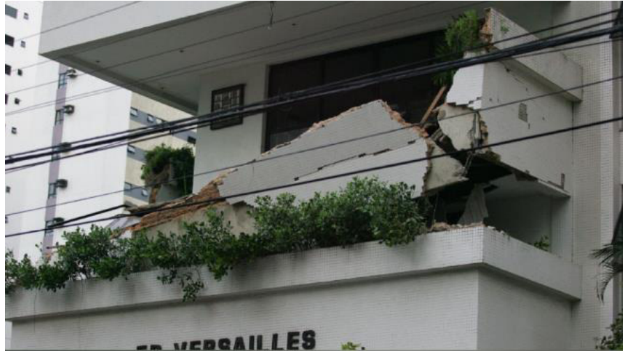
Figura 1 – Queda da varanda do Edifício Versailles.
